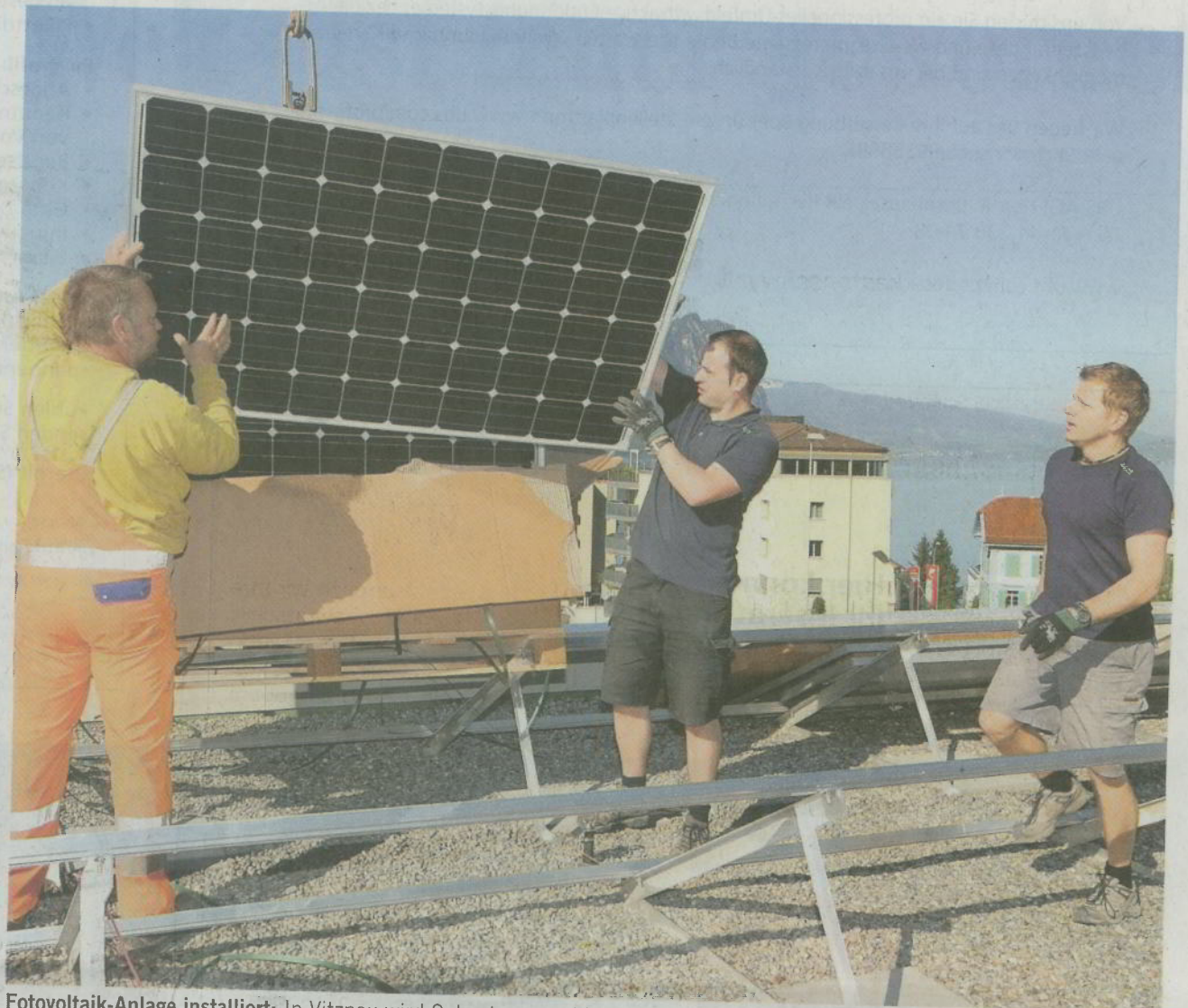
Fotovoltaik-Anlage installiert: In Vitznau wird Solarstrom nachhaltig produziert.
